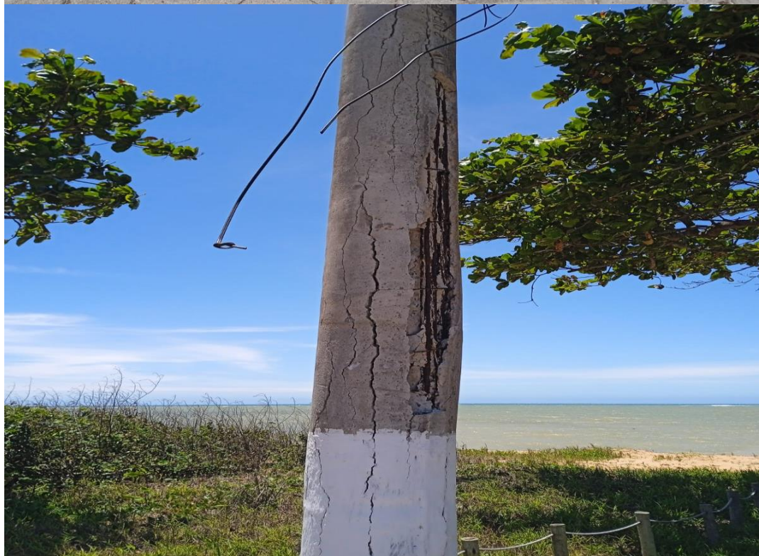
POSTE DE ILUMINAÇÃO A SER TROCADO – BARRA DO SAHY-ARACRUZ-ES
